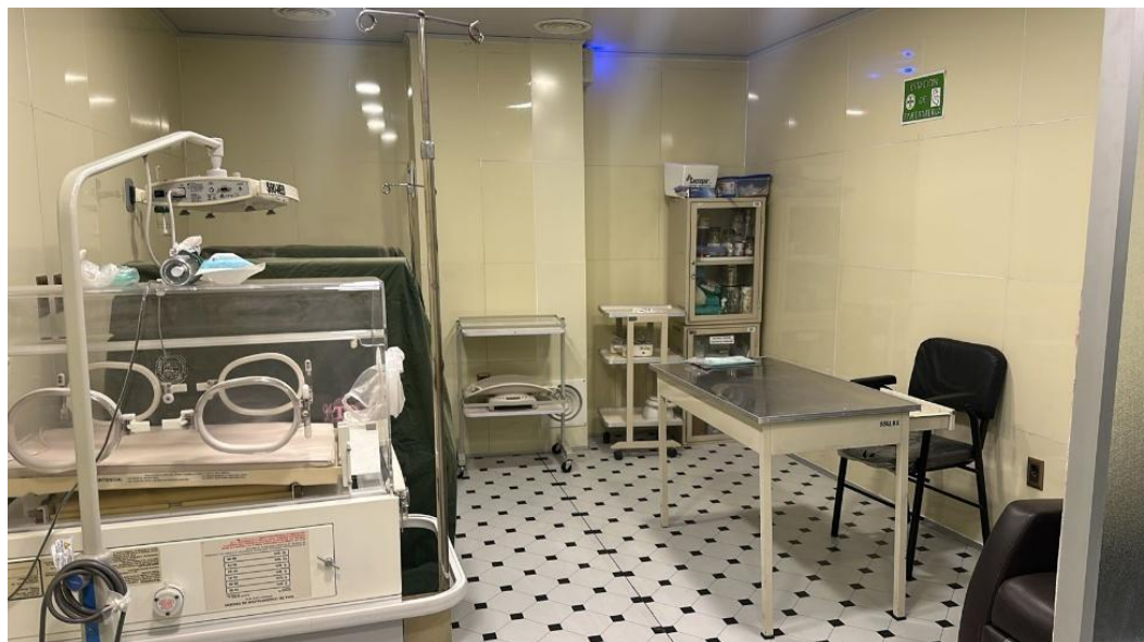
Servicio de Neonatología que cuenta con un sistema de extracción y renovación con aire climatizado filtrado H14
