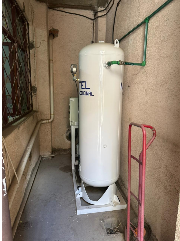
Nuevo equipo "Central de Vacío Medicinal" para Quirófanos, Neonatología y UTI.
